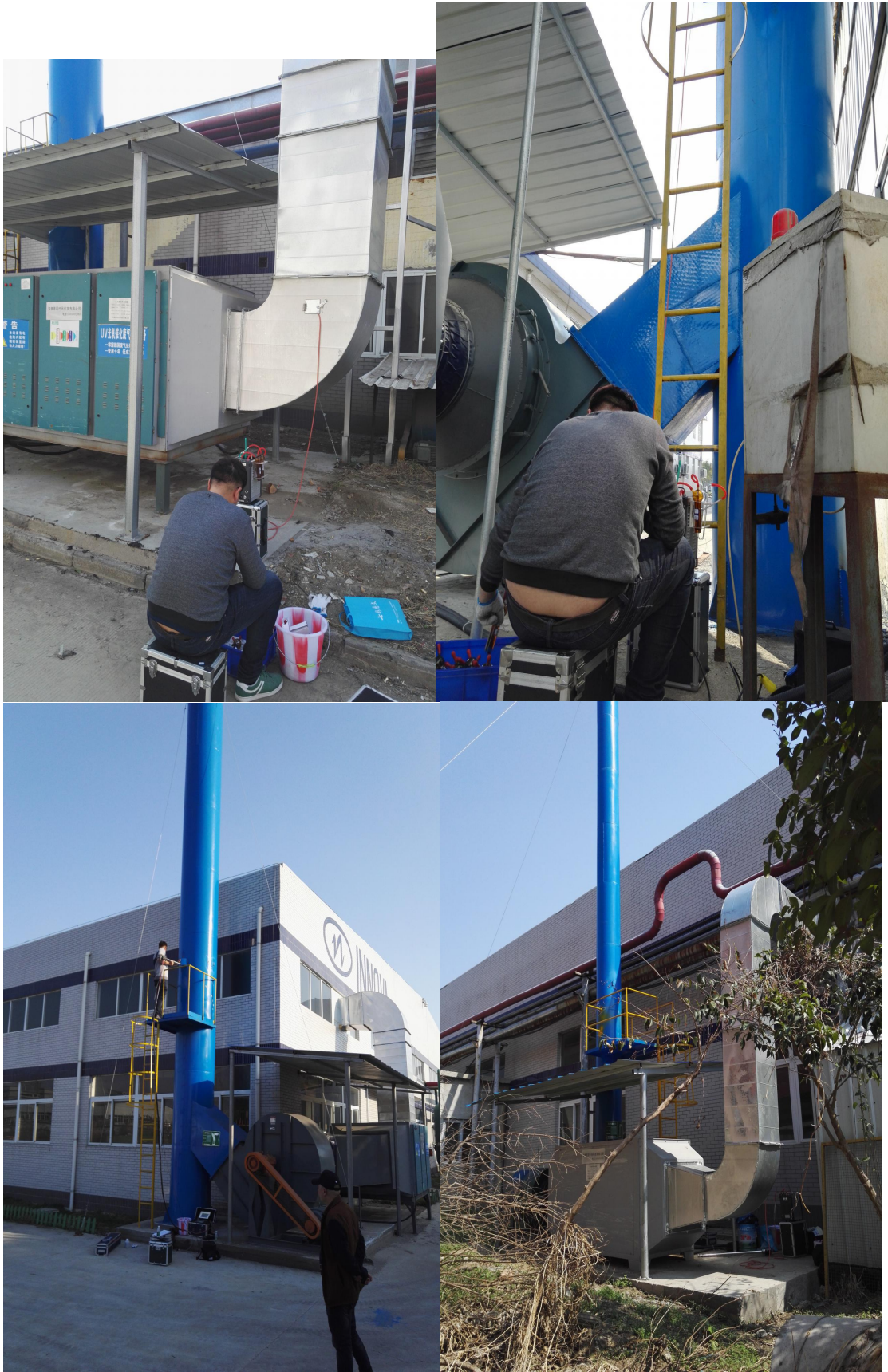
图 5 采样照片及环保设施照片
